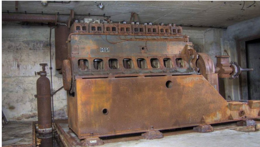
Reichsbahn-Bunker Berlin-Anhalter Bahnhof Notstromaggregat mit MAN-Dieselmotor 1942
