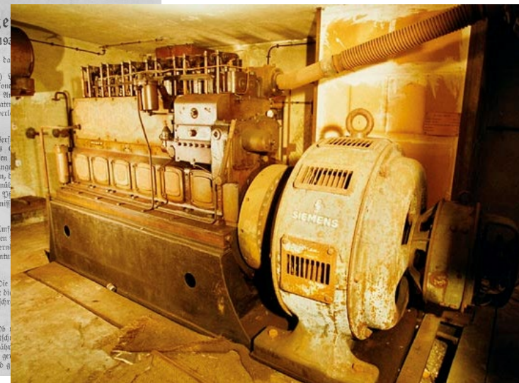
Bunker Berlin-Fichtestraße Notstromaggregat mit Deutz-Schiffsdieselmotor 1941
