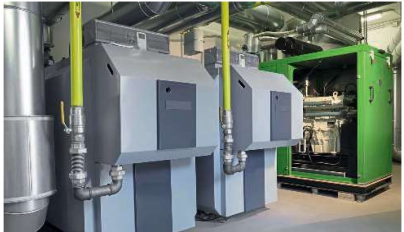
Eine Erneuerung der Anlage macht technisch und wirtschaftlich Sinn, wenn sie älter als zehn Jahre ist.
